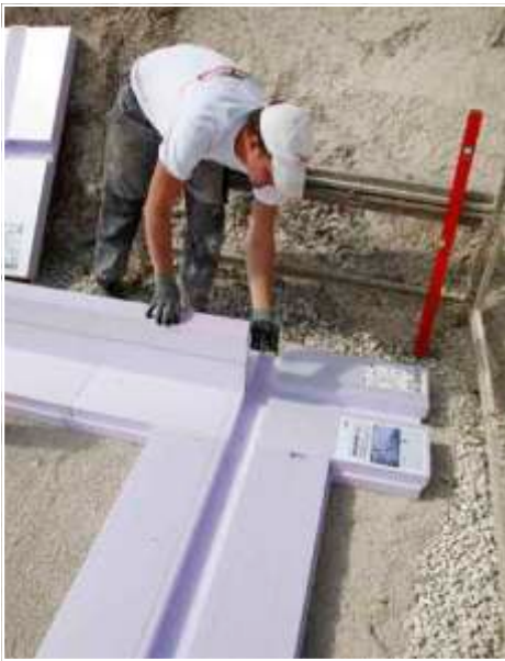
Gestartet wird die Verlegung, mit einem Eckelement, anschließend werden die Seitenteile angelegt. Zuvor muss die Baugrube mit Splitt planeben abgezogen und ausreichend verdichtet sein.
